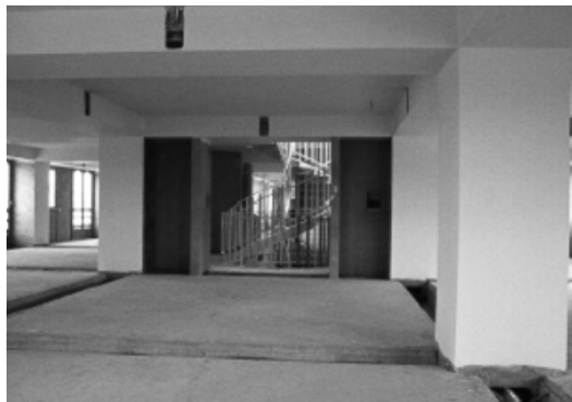
Plateau libre en attente d'aménagement après l'achèvement de la première phase (DAF, CAPA, Archives Maurios).
